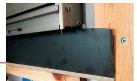
鋼板止水部材をサッシ面に押しつけながら胴縁に留め付けます
