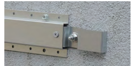
金属胴縁15一般部用(KN2045)を被せて、平頭ねじ(KN65)を使用し留め付けてください。アタッチメント部以外はRC用ビスを使用し、RC躯体へ留め付けてください。
