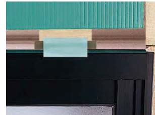
①モエン施工後にモエン開口水抜き部材・バックアップ材を施工する。 (写真はモエンをカットしてあります。)
