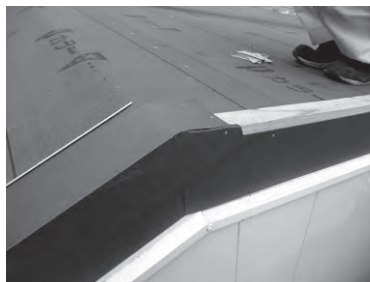
① 大棟部のけらば水切85(110)は図のように切断加工します。
