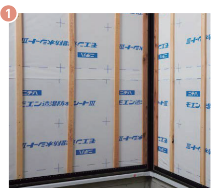
▲鋼板入隅材をモエン用釘または専用ビスで留め付ける
