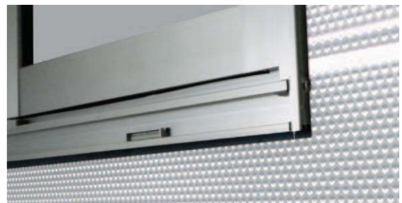
サイディングとサッシとの隙間が小さくなるように施工
